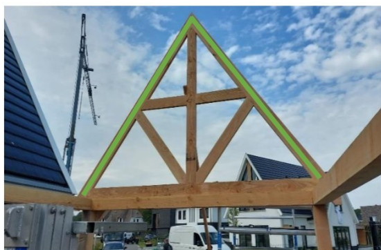
4 KAPCONSTRUCTIE | OVERIGE BALKEN ZIJN NIET INBEREKEND
