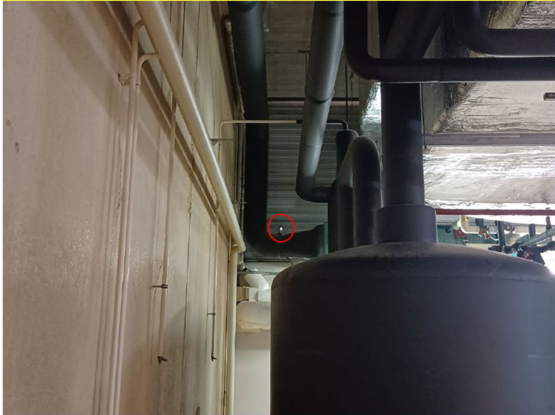
Figuur 3.1 Holte in het metalen rolluik in de technische ruimte (rood omcirkeld)
