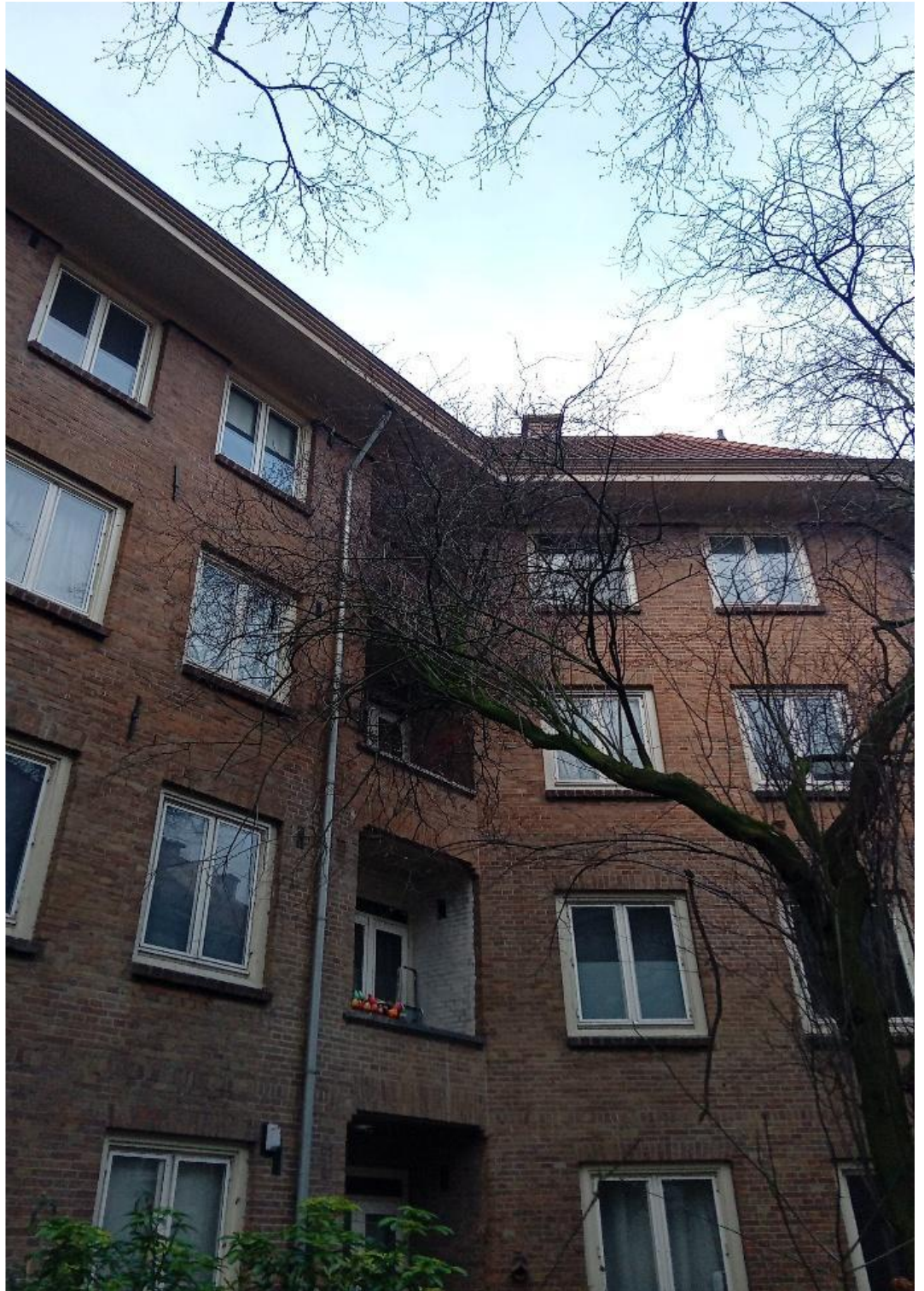
Foto 2. Boom 2841 met tak dicht op bebouwing
