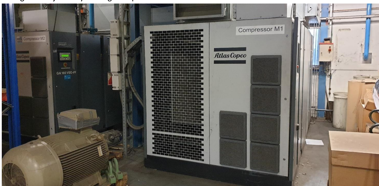
Figuur 29 Opgestelde persluchtcompressoren
