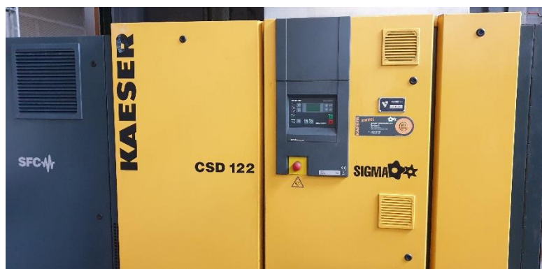
Figuur 41 Opgestelde persluchtcompressoren in de staalfabriek
