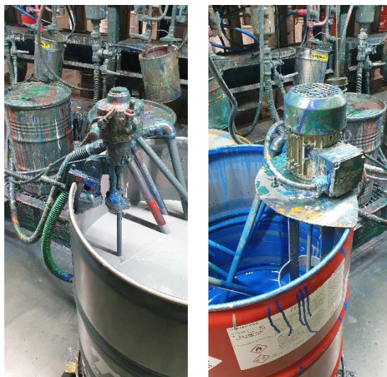
Figuur 34 Verfmengers: perslucht aangedreven (links) en elektrische aandrijving (rechts)
