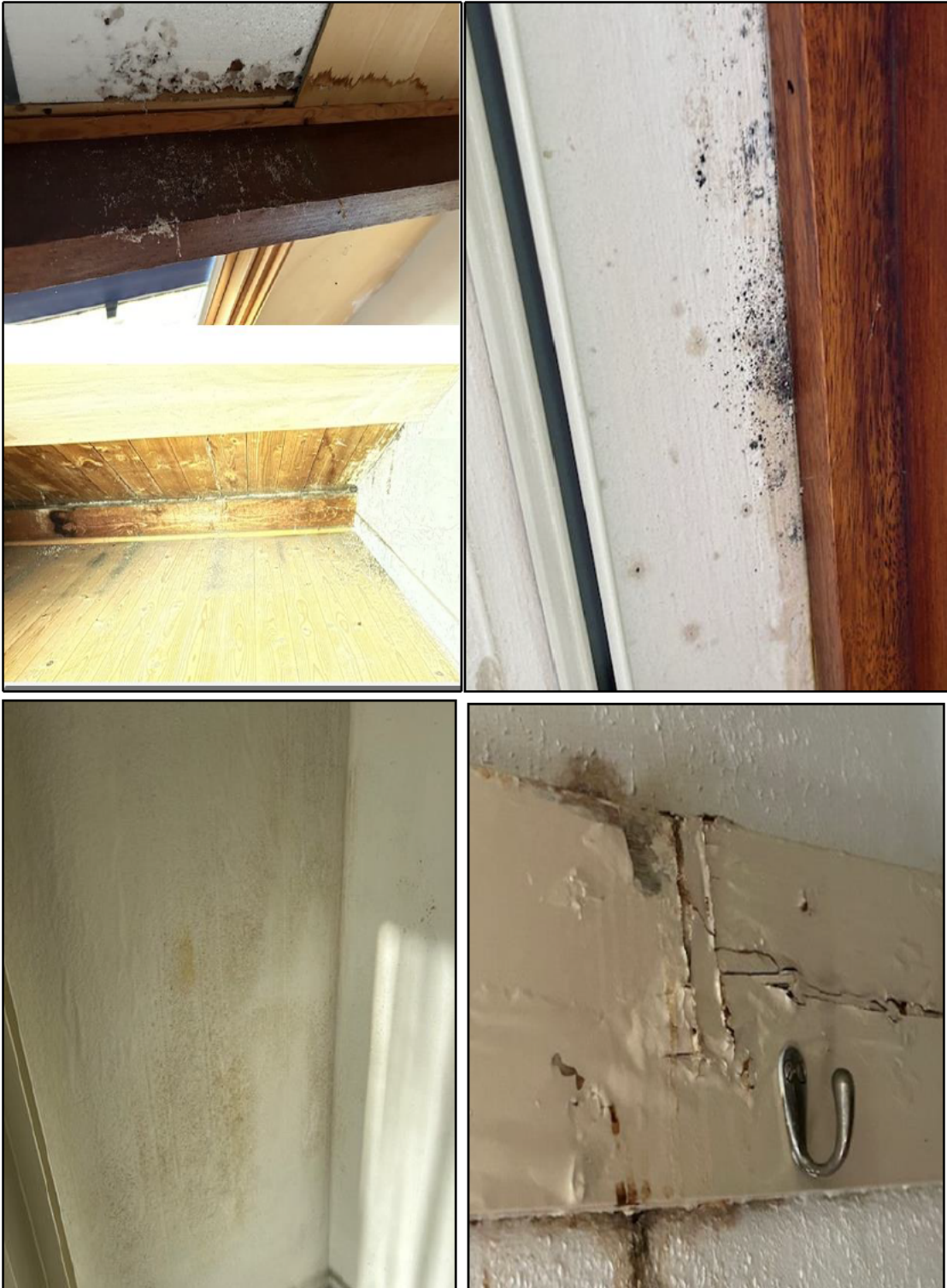
Figuur 6: Lekkage op de zolderverdieping, vochtdoorslag in muren en schimmelvorming in de woning.
