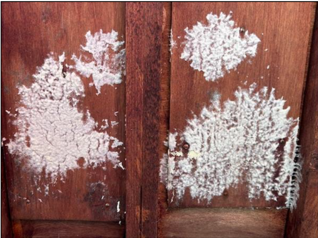
Figuur 7: Vochtdoorslag in de muren en schimmelvorming op houtconstructies in de woning.
