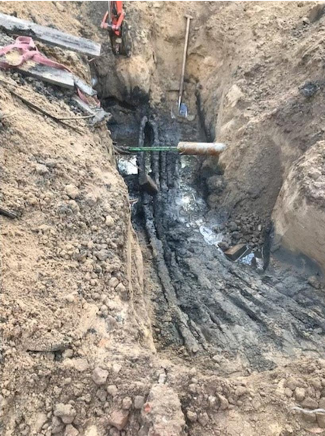
Foto 1: Aangetroffen olieverontreiniging tijdens rooien K&L (foto van K&L-aannemer)
