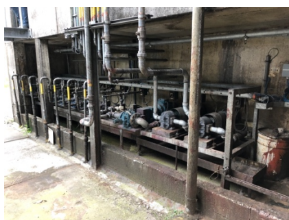
Figuur 29. Pompen t.b.v. bovengrondse en ondergrondse opslagtanks (3).
