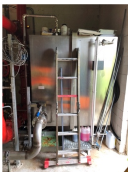
Figuur 35. Installatie (schuimvormend middel) in de pompkamer (36).
