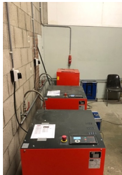
Figuur 20. Compressoren (ruimte tussen M1 en M2).
