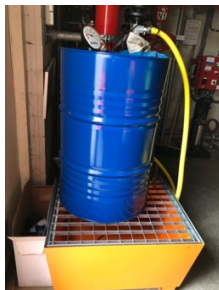
Figuur 34. Dieseltank in de pompkamer (36).
