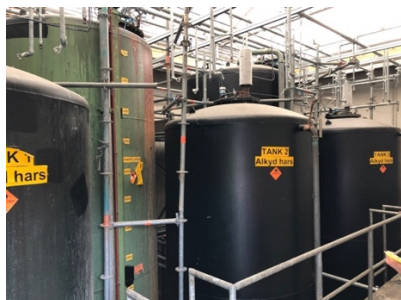
Figuur 27. Bovengrondse opslagtanks (1)
