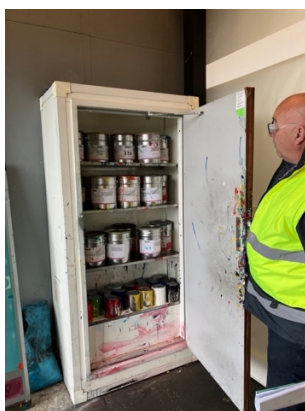
Figuur 5. Opslagkast bij de screeninktopslag (11).
