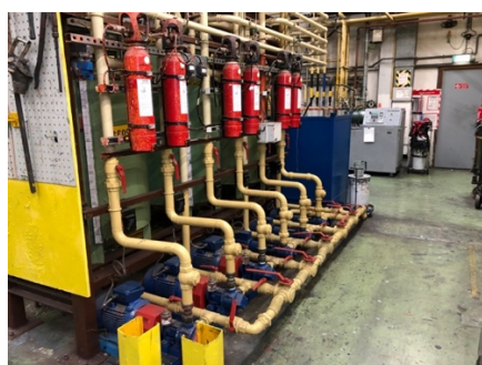
Figuur 12. Procesinstallatie verffabriek (T).
