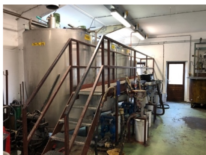
Figuur 22. Procesinstallaties – watergedragen lakken (M2).
