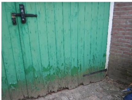
Houtrot in onderzijde van staldeur tussen gevel g06 en g07.
