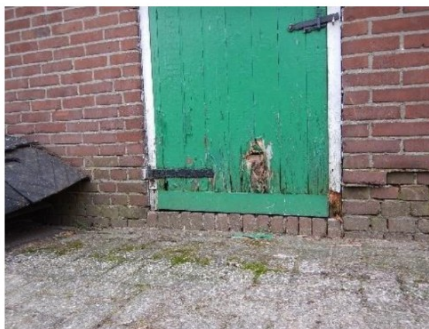
Houtrot in deur en kozijn in gevel g08.
