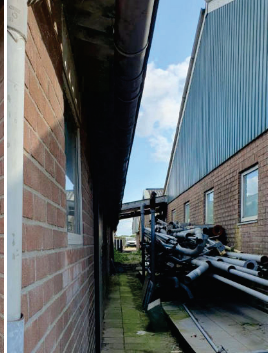
Foto 2: dakgoot westzijde gebouw 8 en 9
