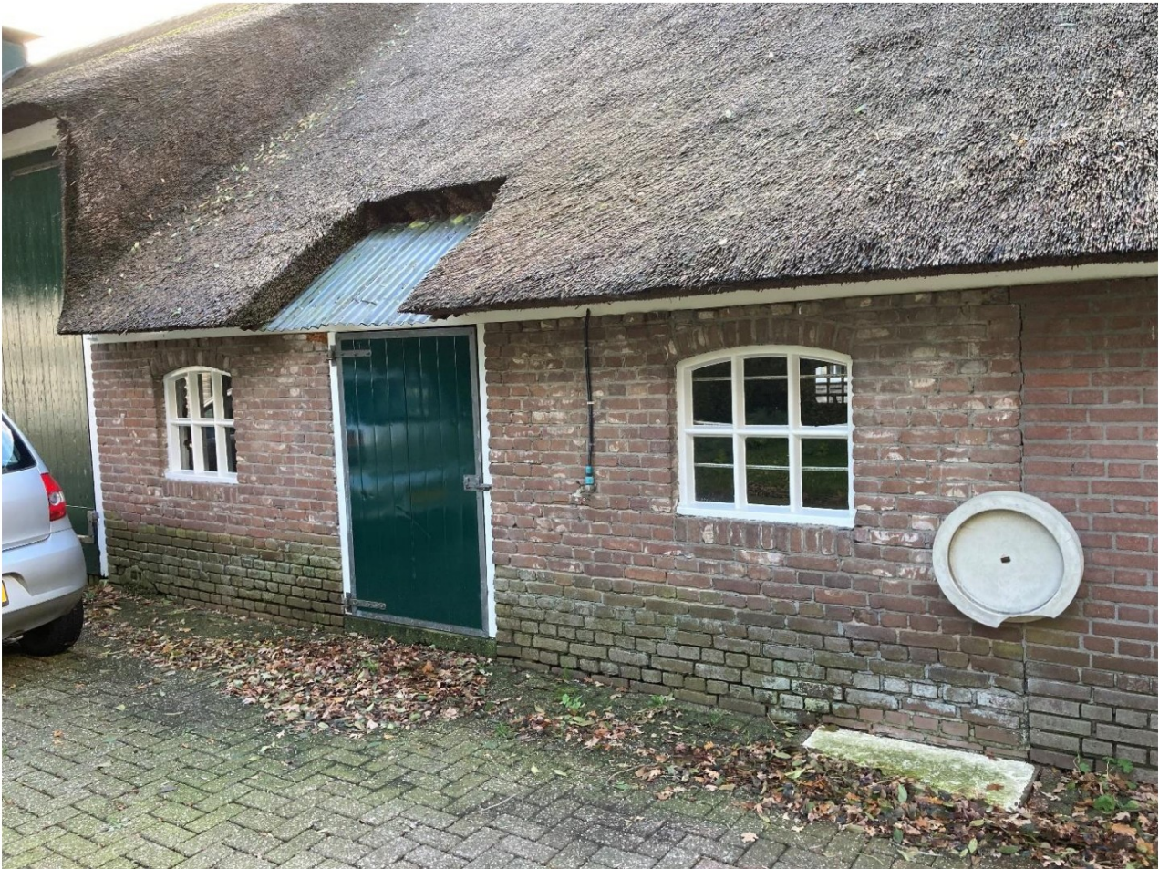
Fig. 51; achter 2 e stalraampje oud metselwerk Rechts nieuw metselwerk (1990) vanaf entreepui en links opgetrokken met gebikte stenen. Dit is het enige stuk met oud(er) metselwerk in de Oostgevel. Het overige is allemaal jonger en met jongere stenen.
