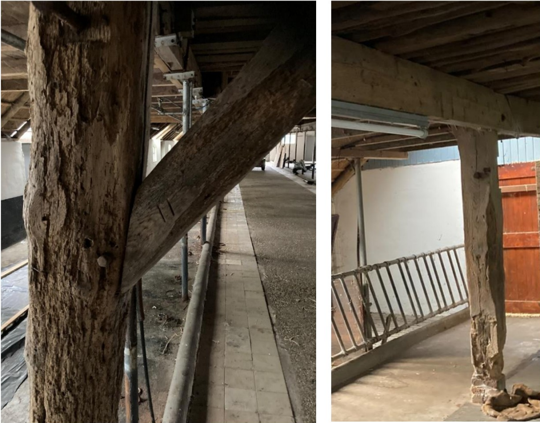
Fig. 24 en 25; Gebint met telmerk II en penverbinding. Aantasting te zien, ook bij gebintstijl nr.3
