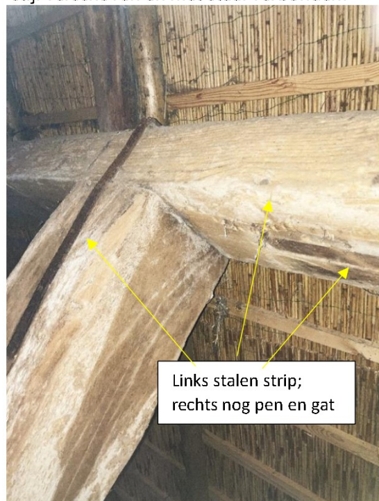
Fig. 30; Duidelijk zichtbare verplaatsing stijl
