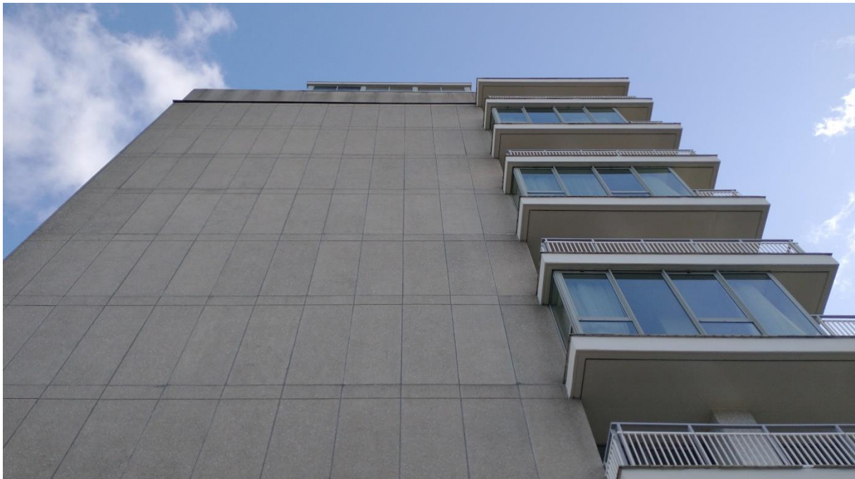
Aanzicht van de westgevel vanaf het platte dak van de onderbouw. Het verticale patroon van de schokbetonnen gevelbekleding wordt doorbroken door horizontale lijnen ter plaatse van de vloeren.
