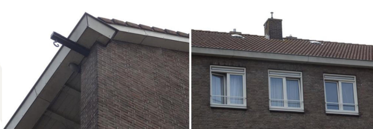
Figuur 4: Links, openingen tussen het Trespas en de dakpannen. Rechts: vlak dakvlak met aaneengesloten pannen.
