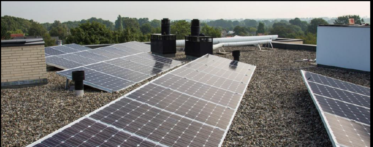
Figuur 13: Zonnepanelen met grind (bron: slimster.nl).
