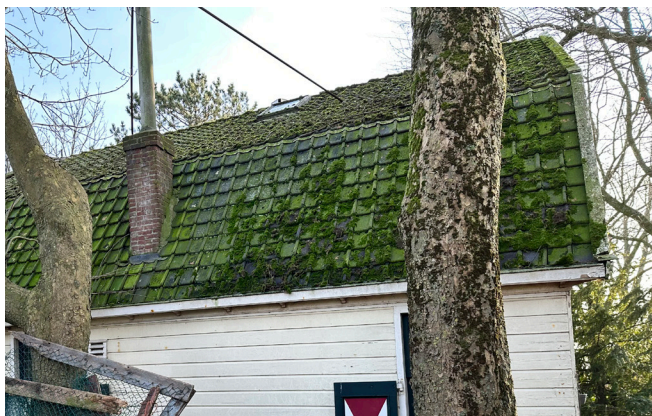
verweerde en loslatende dakpannen
