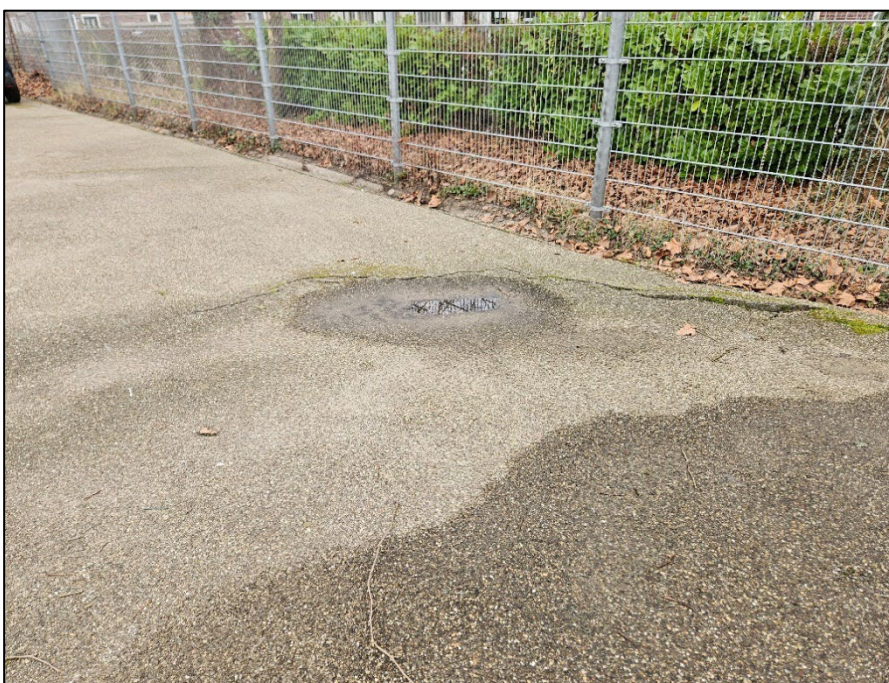
Figuur 28: Scheuren in het asfalt door wortels die de bestrating omhoog drukken.
