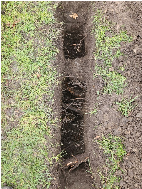
Figuur S: Oppervlakkige wortels van boom 49.
