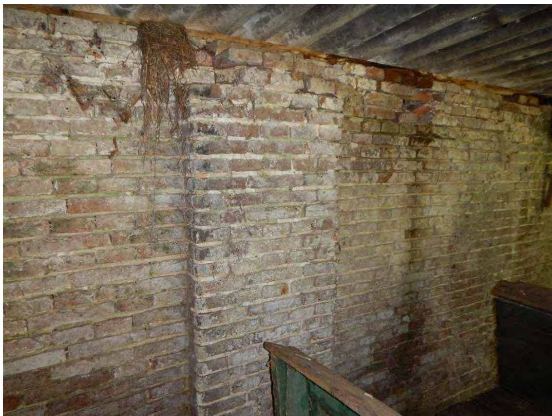
05 Tuinmuur is aan de bovenzijde ingekort waardoor er niet meer een duidelijke afwerking waarneembaar is.
