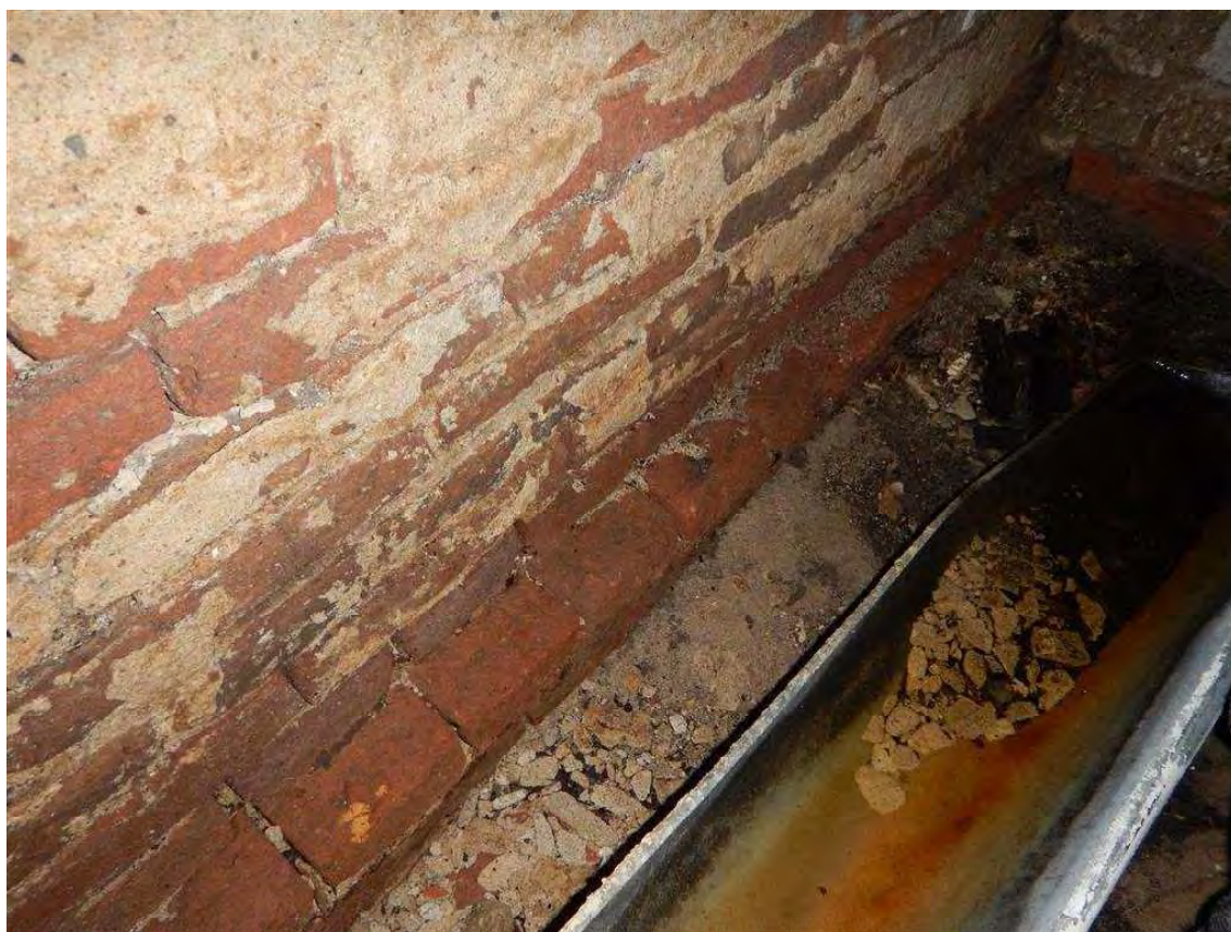
08 Verbrede fundatievoet zichtbaar door wegspoelen grondslag door lekkende dakgoot.
