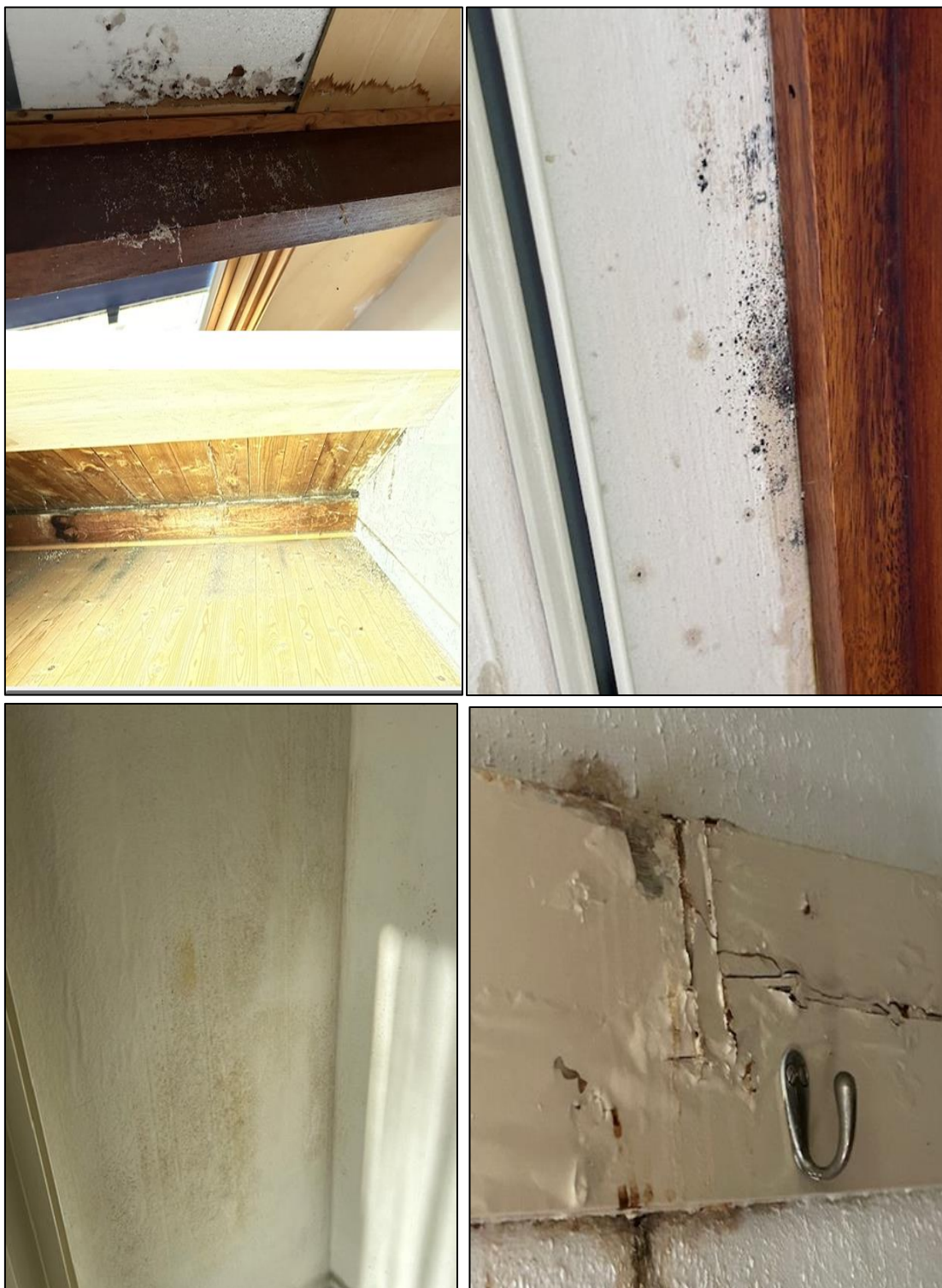
Figuur 6: Leckage op de zolderverdieping, vochtdoorslag in muren en schimmelvorming in de woning.
