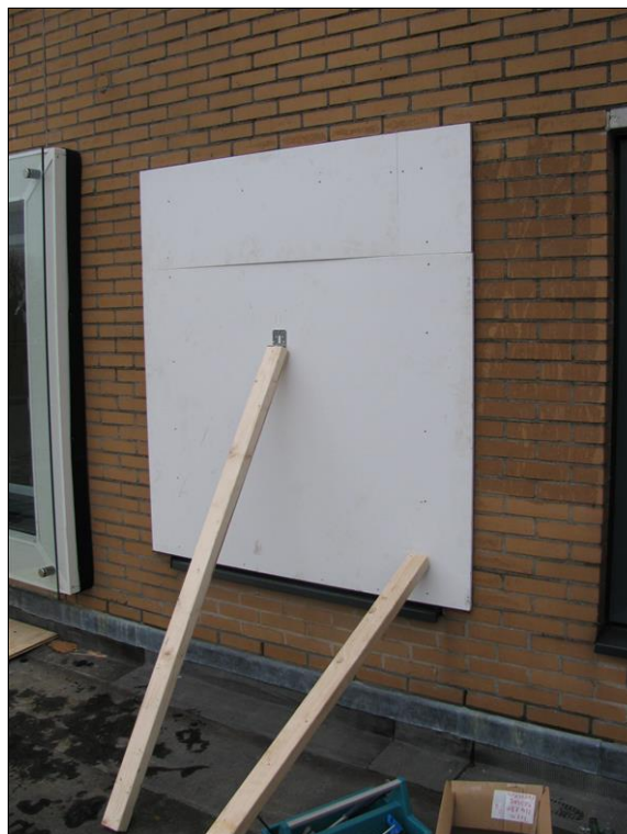
Foto II.4 Provisorische afdichting tweede raam
