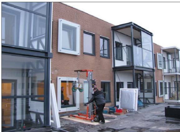
Foto II.1 Aanzicht glazen gevelgeluidschermen
