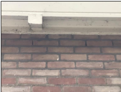
Foto 11. Stootvoegen in de muur van de rijtjeswoningen
