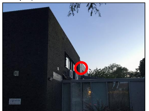
Foto 14. Locatie ingang kraamverblijfplaats achter metalen dakstrip, in de hoek waar de twee gebouwdelen samenkomen (aangegeven met rode cirkel)
