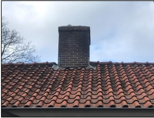
Foto 9. Openingen onder loodslabben van schoorsteen van rijtjeswoningen
