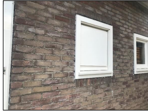
Foto 10. Openingen tussen muur en kozijnen van rijtjeswoningen
