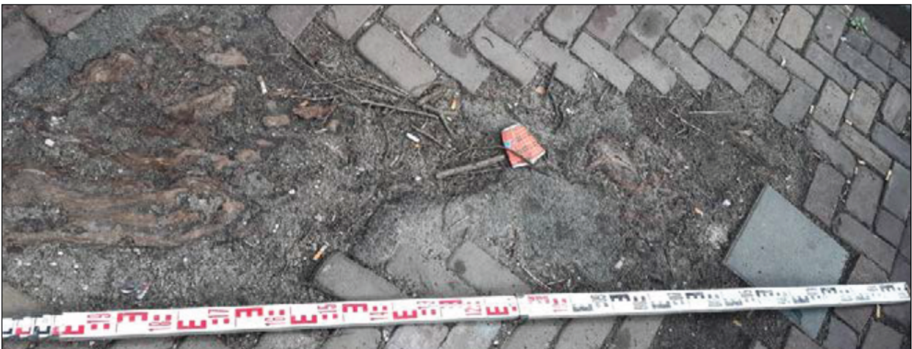
Afbeelding 6: Beworteling aan het maaiveld, stenen zijn hier al weg gehaald.
