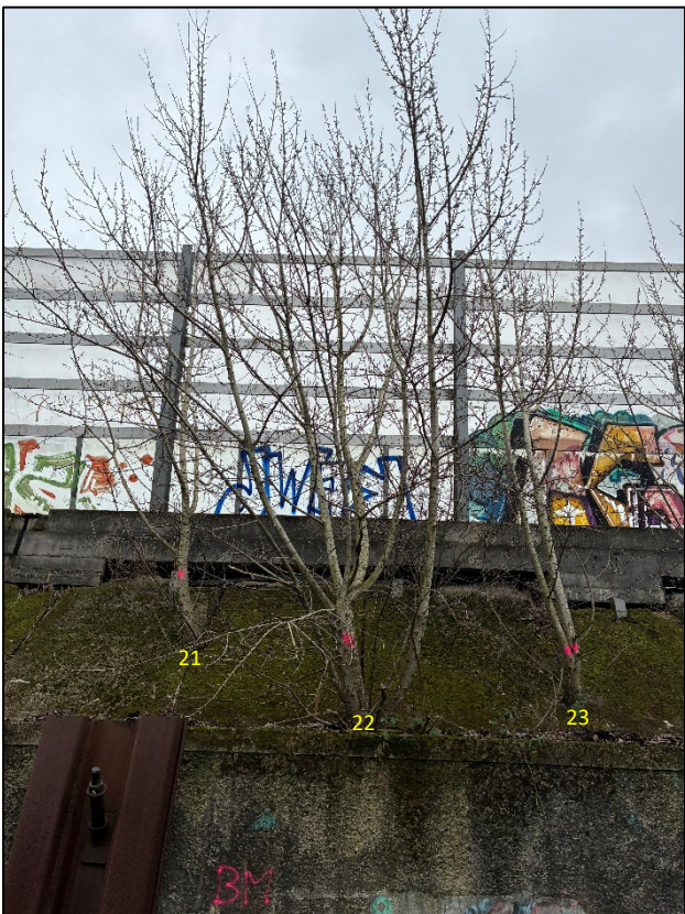
Zicht op boom 21 - 23 in het steile talud met elementverharding (betonplaten) aan de westzijde.
