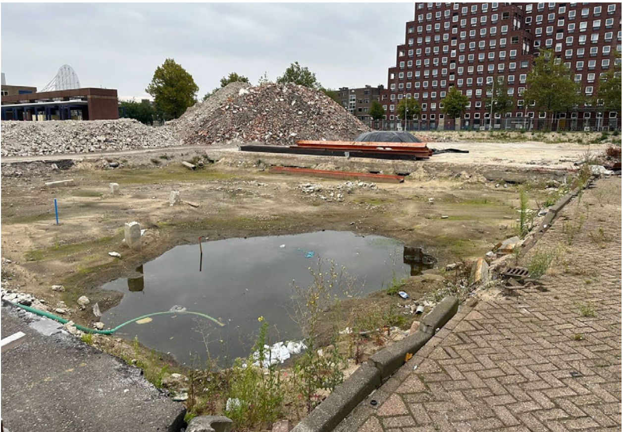
Foto 01: Overzicht onderzoekslocatie richting het zuidoosten ter plaatse van de reeds gesloopte betonvloer van het vml. bedrijfspand FC-140. In het diepste gedeelte staat hemel-/grondwater. Achterin op de resterende betonvloer van het vml. bedrijfspand FC-140 het gronddepot (ca. 25 m 3 ) onder folie.
