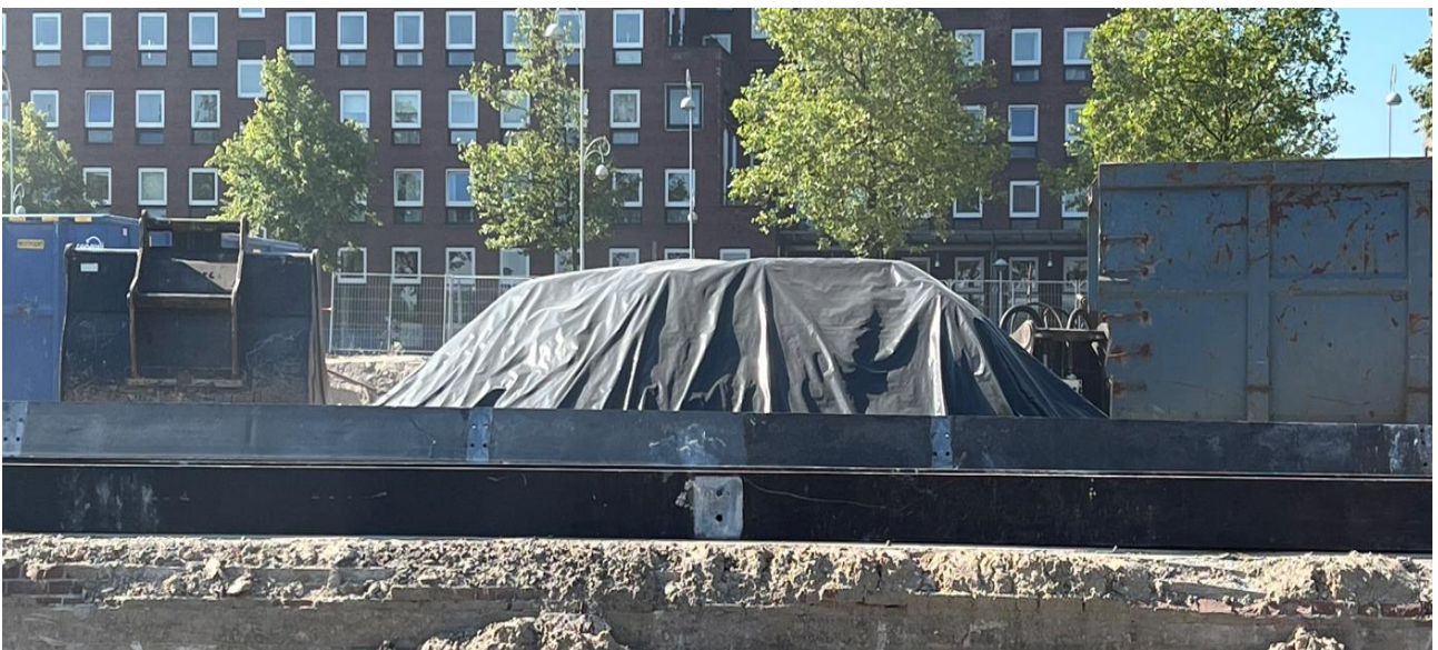
Foto 04: Depot onder folie en liggend op de betonvloer van het vml. bedrijfspand.
