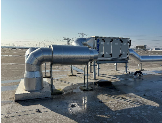
Afbeelding 3: Overzicht installaties op het dak
