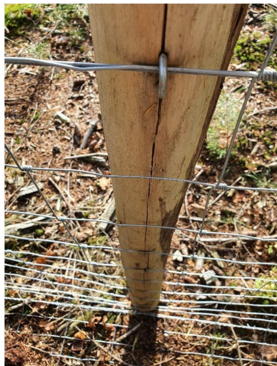
Figuur 7: te weinig krammen, niet schuin en in één lijn
