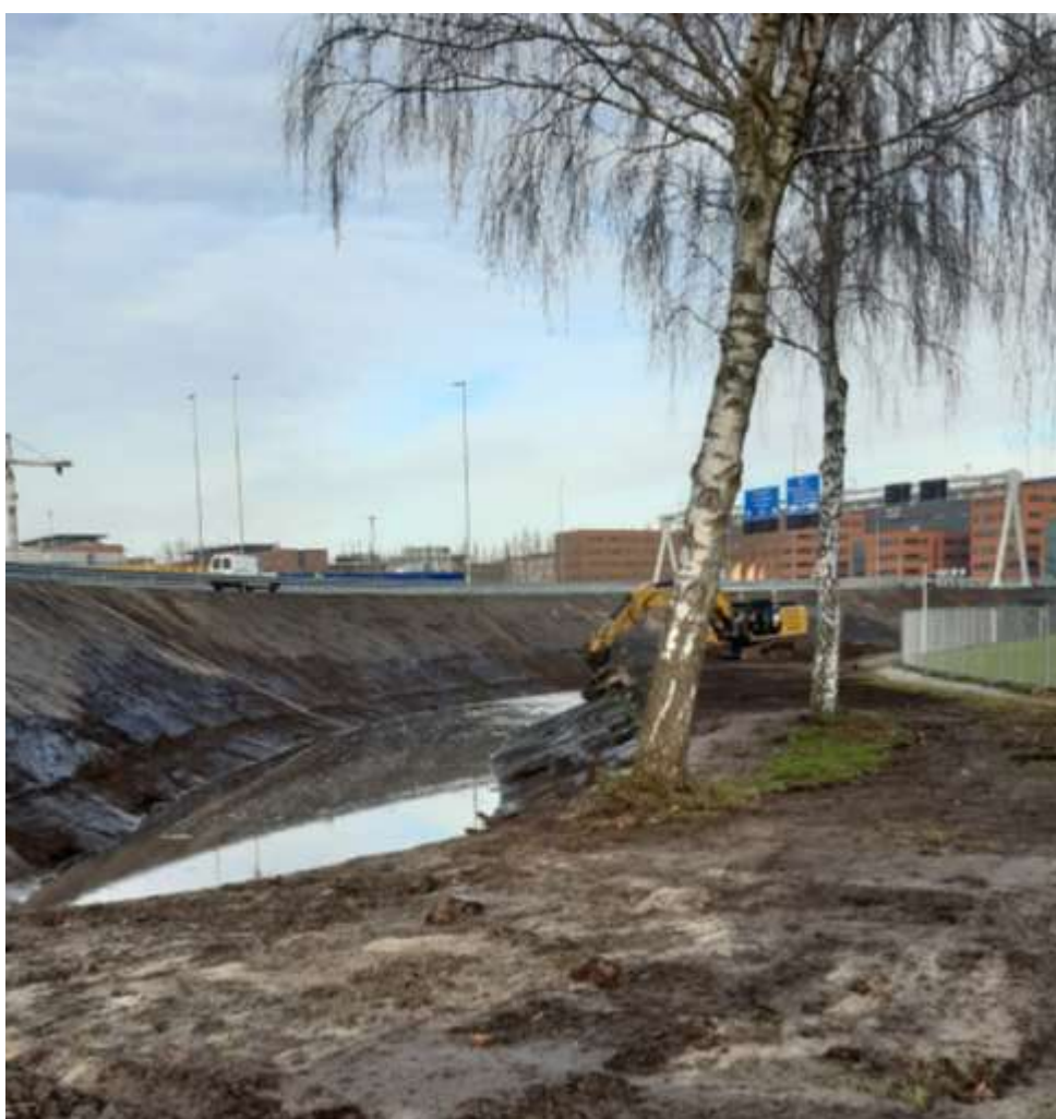
Foto 4 Structureel verlies van ondergrondse ruimte
