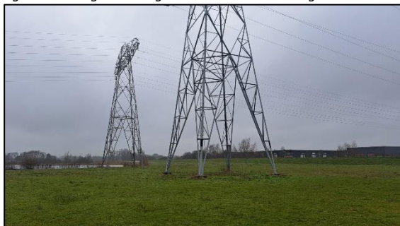
Figuur 2.9. Hoogspanningsmasten langs de zandwinlocatie.
