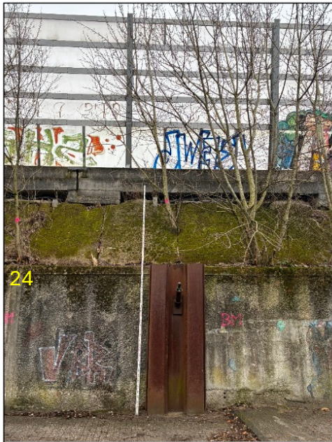
Figuur 14: Locatie van boom 21-24 in steil talud met elementverharding en aangeven baak van 5 meter.
