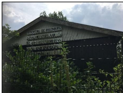
Foto 23. Openingen tussen dak en muur van gebouw op de kinderboerderij
