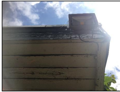
Foto 20. Openingen tussen de houtplaten aan de onderkant van het dak van het gebouw op de schoolwerktuinen
