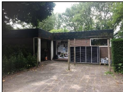
Foto 25. Opening tussen boeiboord en muur van het gebouw op de schoolwerktuinen
