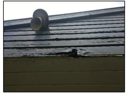
Foto 21. Openingen en kieren in de muur en het dak van het gebouw op de schoolwerktuinen
