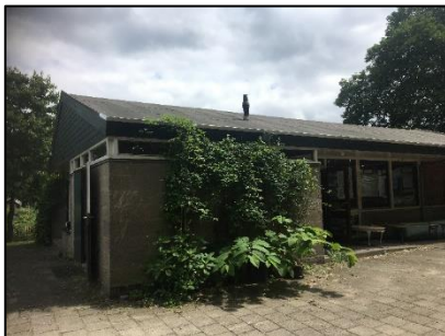
Foto 26. Diverse openingen tussen en onder het dak van het gebouw op de schoolwerktuinen
