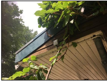
Foto 19. Overhangend daktrim en openingen tussen dak en houtplaten van het gebouw op de schoolwerktuinen
