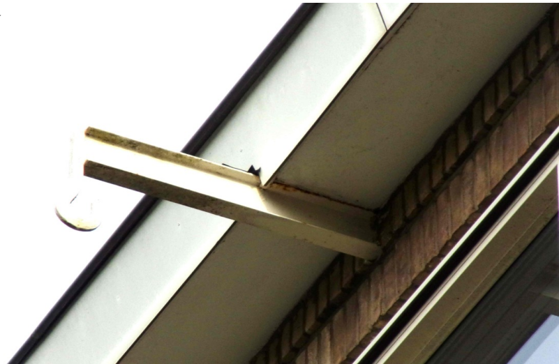
gevel lange kant met dakgootombouw waar baltsroepende gewone dwergvleermuizen worden waargenomen maar waar niet duidelijk is waar de schuilplaats van het baltterritorium zou kunnen zijn
