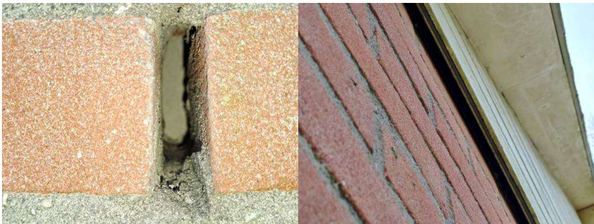
Foto links open stootvoeg in de buitengevels van de woning. Foto rechts; Kieren tussen houten topgevel en buitengevels van woning.
