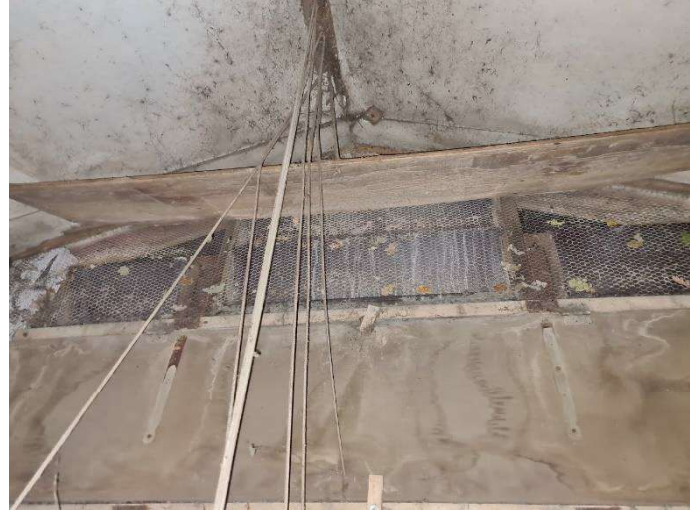
Figuur 5.6: gaasnet in luchtinlaat - binnenzijde
