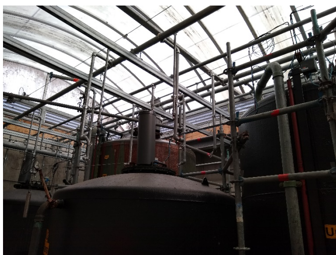
Figuur 3.2 Bovengrondse opslagtanks
