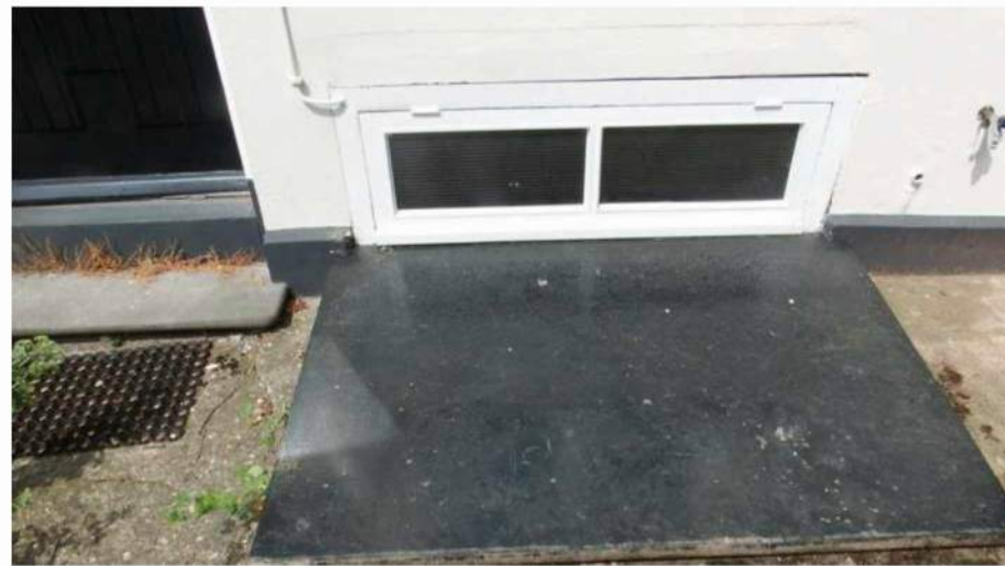
Afb. 37: Een twee lichts venster rechts naast de deuropening. Het venster is geplaatst op een luik op de buitentrap afsluit.
