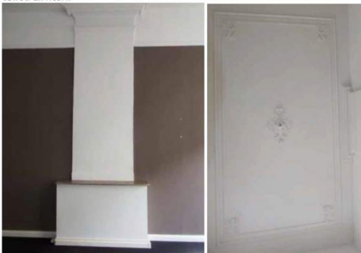
Afb. 48: Links de een gestucte schoorsteenmantel en een gestuct plafond met perklijst, hoekornamenten en middenrozet.
