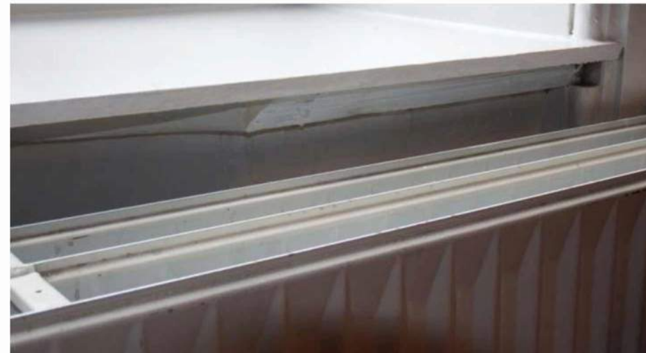
Afb. 24: Details van de afgehakte vensterbank in de vensternis.
